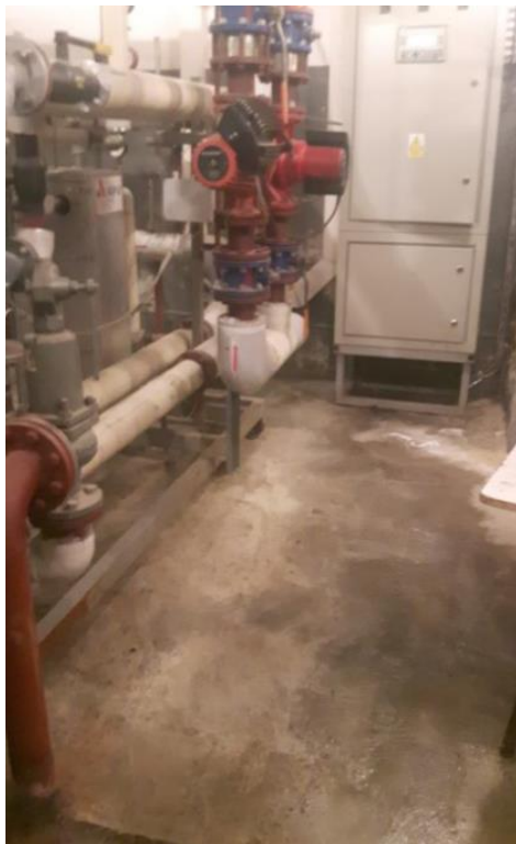
Rys. 3. Widok na węzeł ciepły oraz pomieszczenie węzła, brak zabezpieczenia posadzki przed działaniem wilgoci
