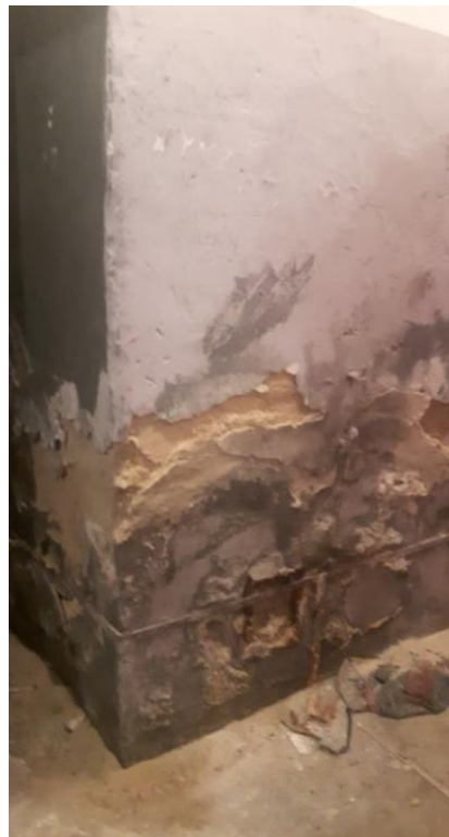
Rys. 4. Zły stan techniczny przegród wydzielających pomieszczenie węzła ciepłego wynikający z długotrwałego stanu zawilgocenia
