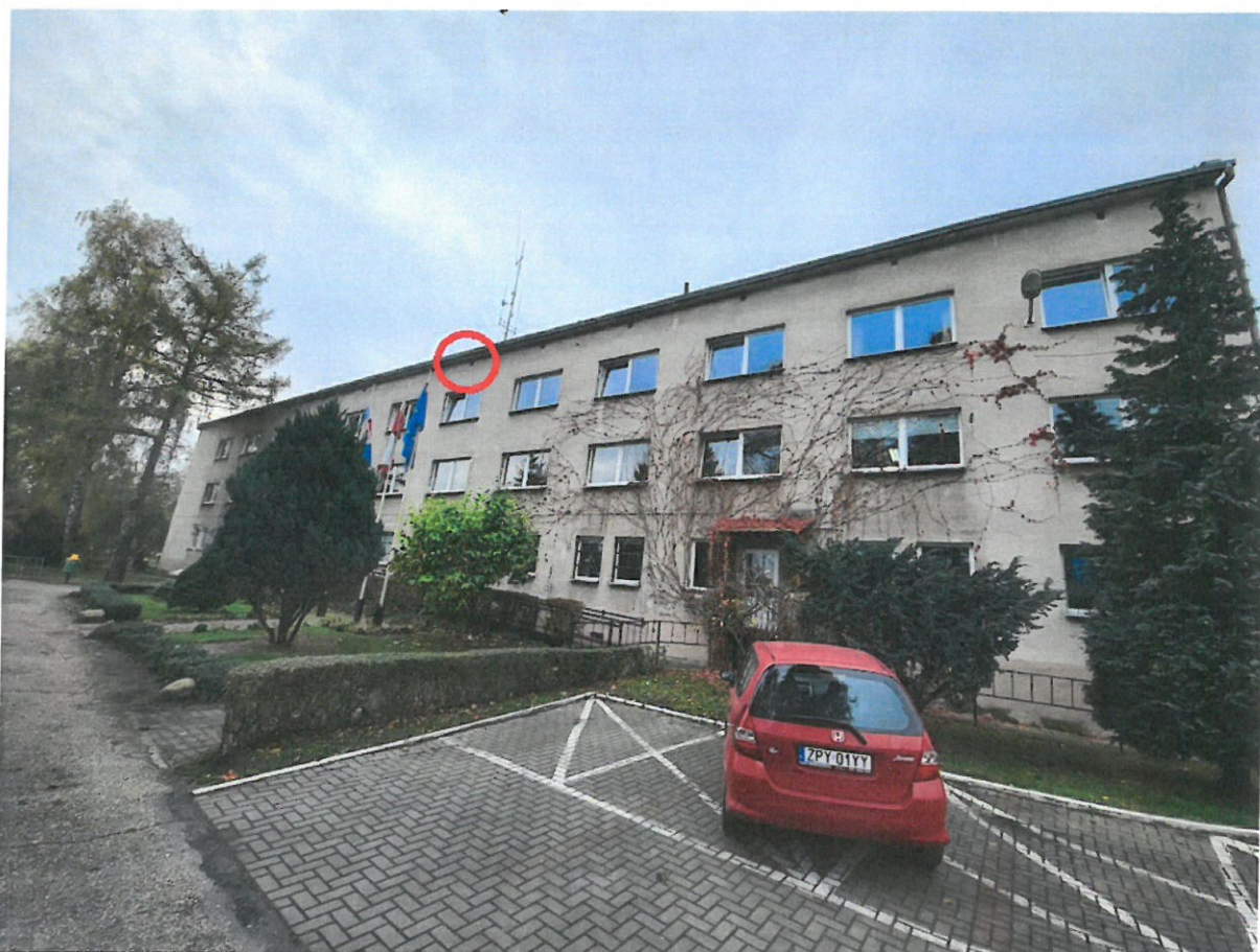
Fot. 7 Ściana podłużna wschodnia z potencjalną niszą wróbla w otworze wentylacyjnym strychu.
