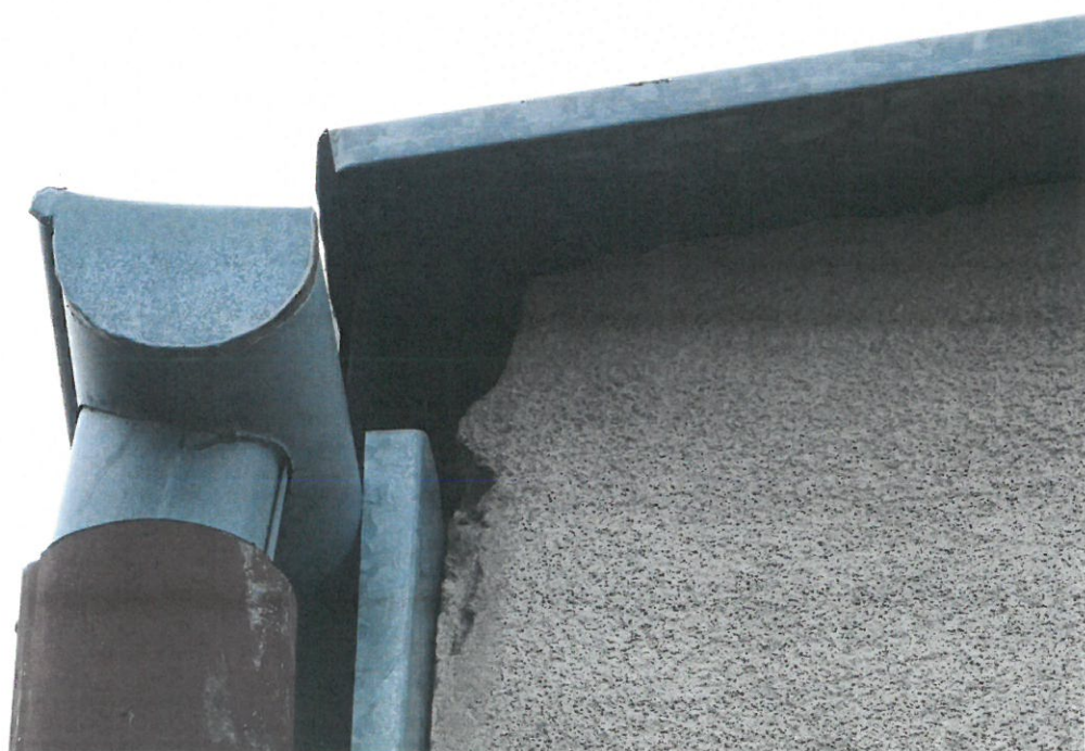
Fot. 2 Potencjalna nisza lęgowa wróbla/jerzyka i nietoperzy pod obróbką blacharską.
