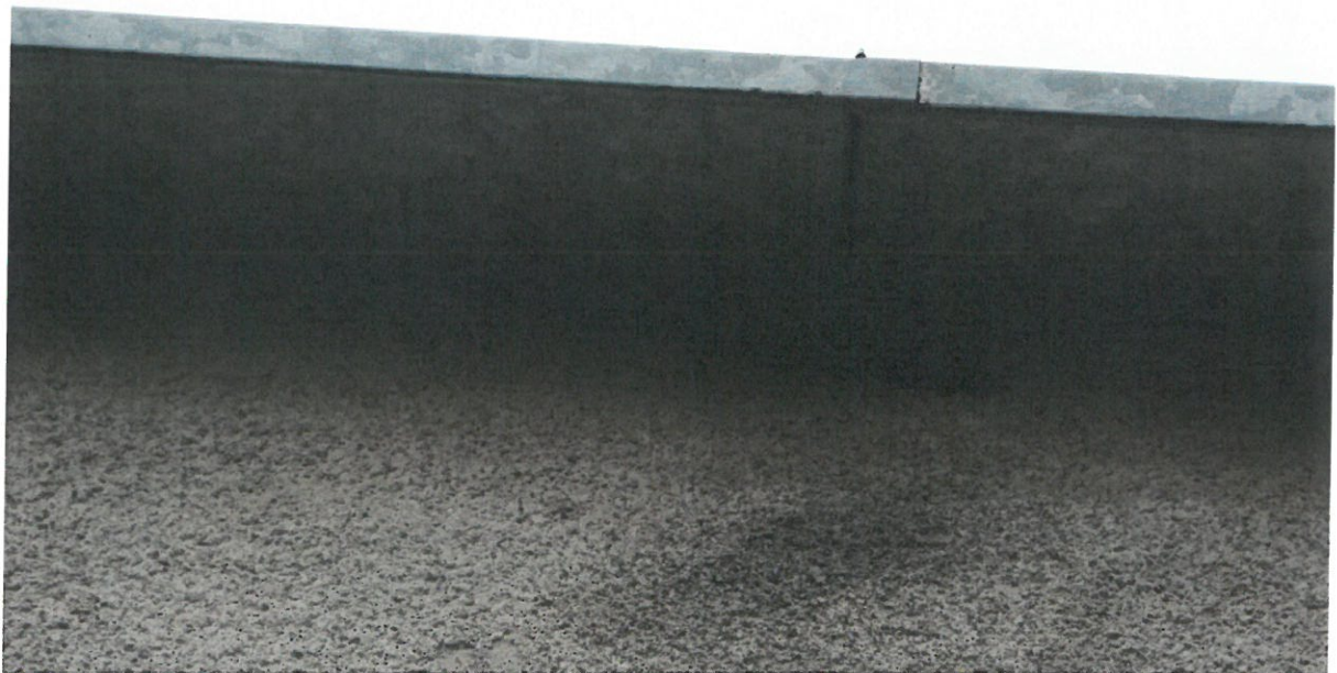
Fot. 5 Potencjalna nisza lęgowa wróbla/jerzyka i nietoperzy pod obróbką blacharską.
