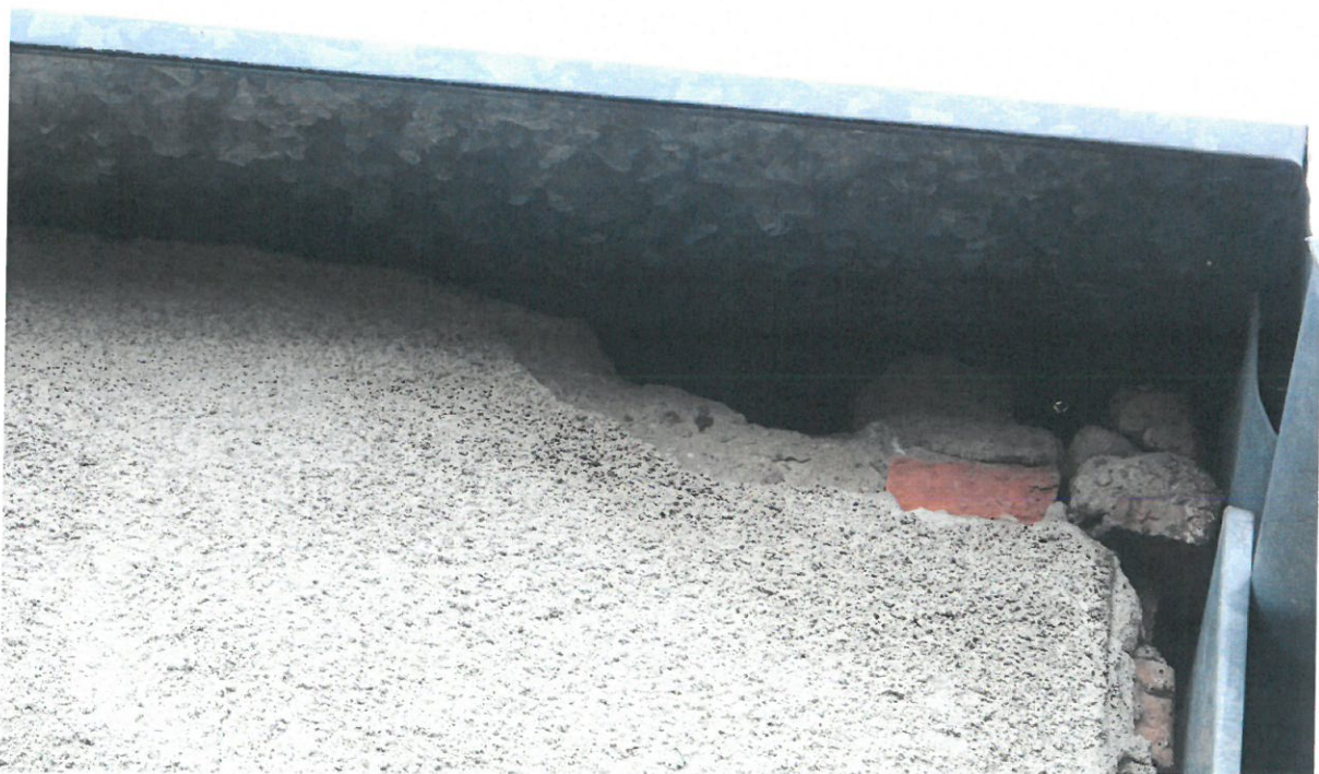
Fot. 4 Potencjalna nisza lęgowa wróbla/jerzyka i nietoperzy pod obróbką blacharską.
